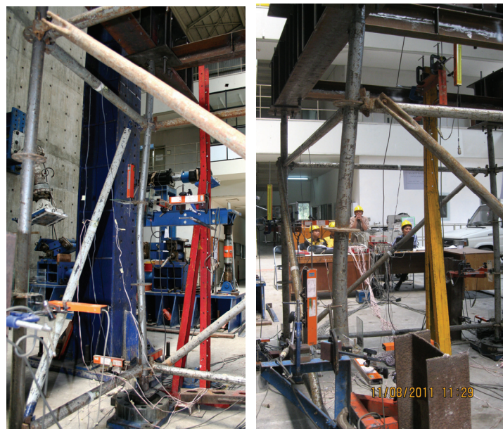
Gambar 3. Bentuk kerusakan pada kolom perancah baja
